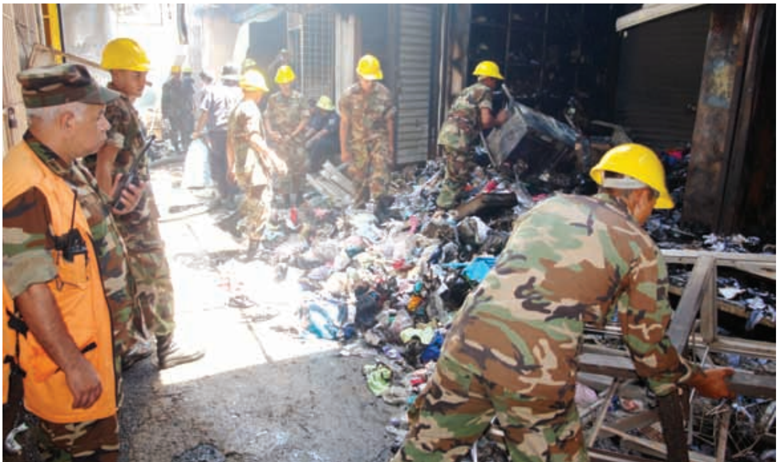
Escombros en el Mercado Oriental, Managua, agosto de 2008. (DRPE)
