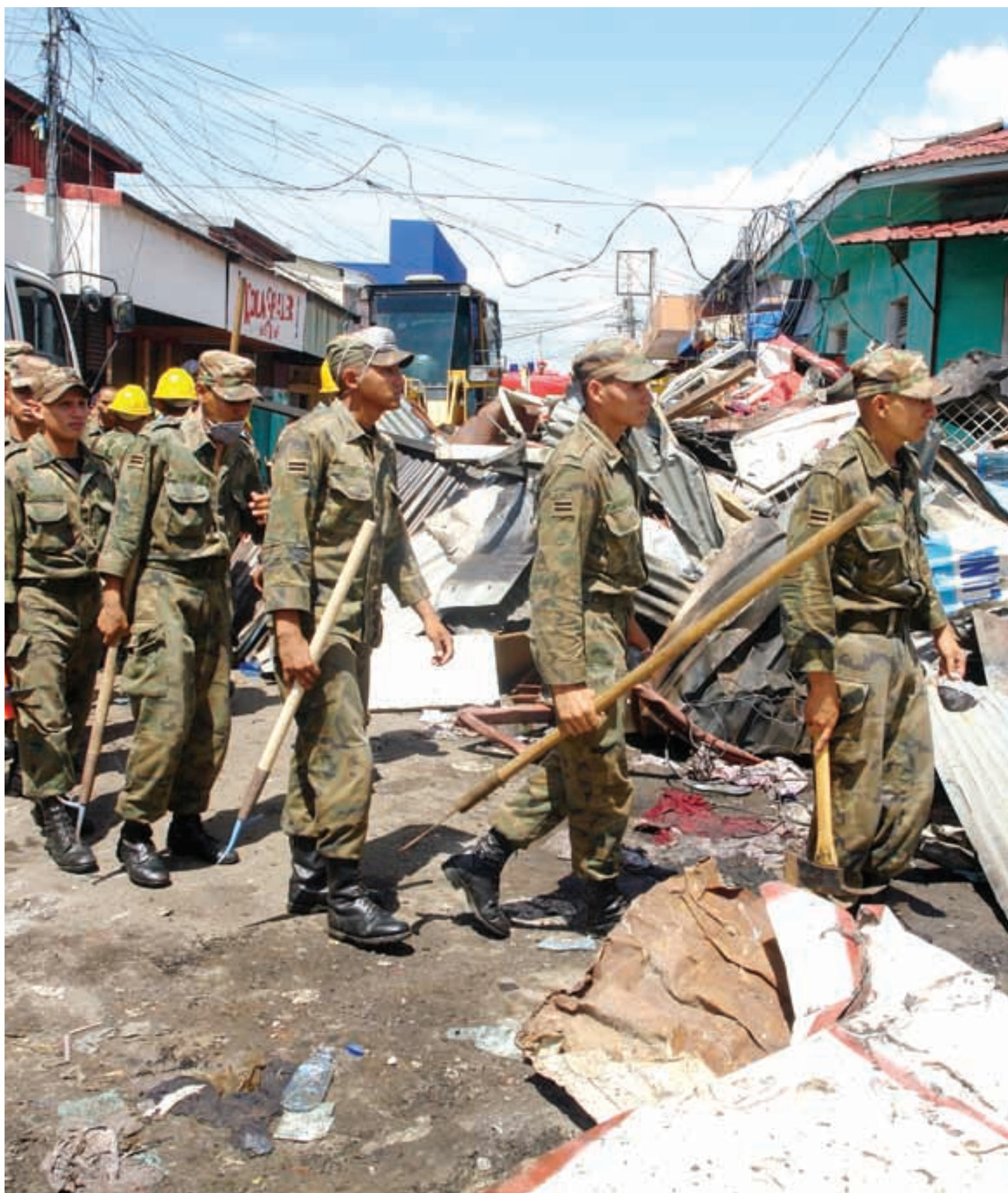
Escombros en atención a desastre antropogénico "Incendio en el Mercado Oriental, Managua", agosto del 2008. (DRPE)
